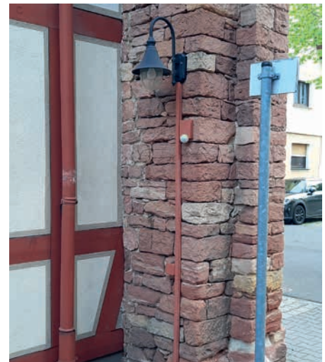
Neue Außenbeleuchtung Seniorenwohnanlage Huthmacher Str.
