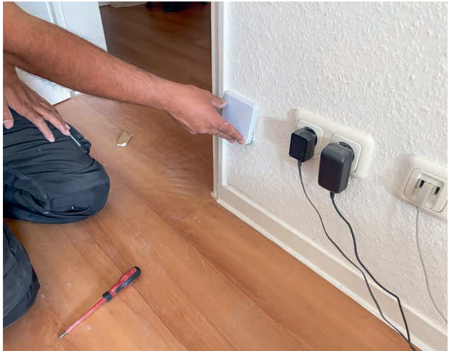
Die Dosen für das Glasfaserkabel sind schon in vielen Wohnungen montiert. Jetzt muss noch die Telekom liefern.
