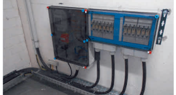
Modernisierung Elektroanschlüsse Hermann-Küster-Str. 58–62 – 2. BA Kosten in 2025: ca. 54 TEUR
